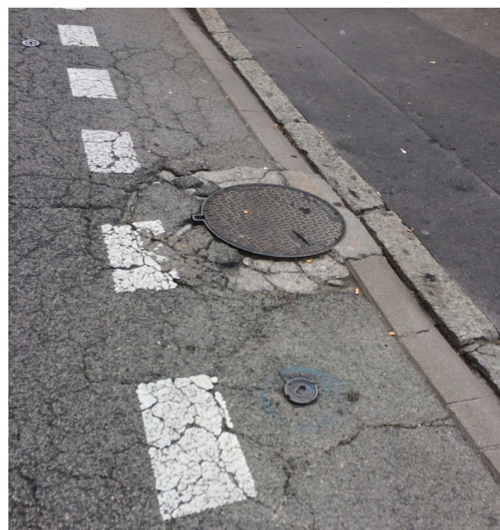
Mauvais état des routes / bandes cyclables (av. de Cran)
